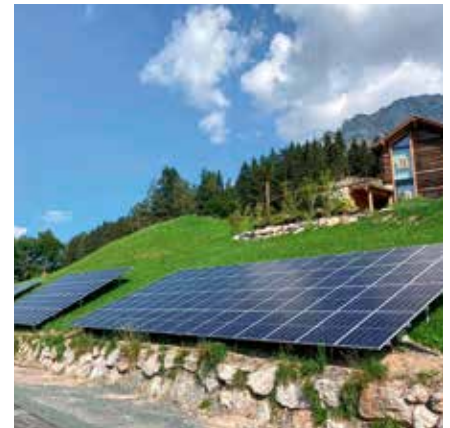
115 Tonnen CO 2 können mit den 432 PV-Modulen eingespart werden.
