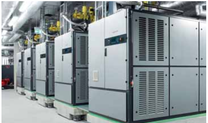
Fünf Vitobloc 200 Blockheizkraftwerke im Verwaltungsgebäude der Deutschen Gesetzlichen Unfallversicherung
