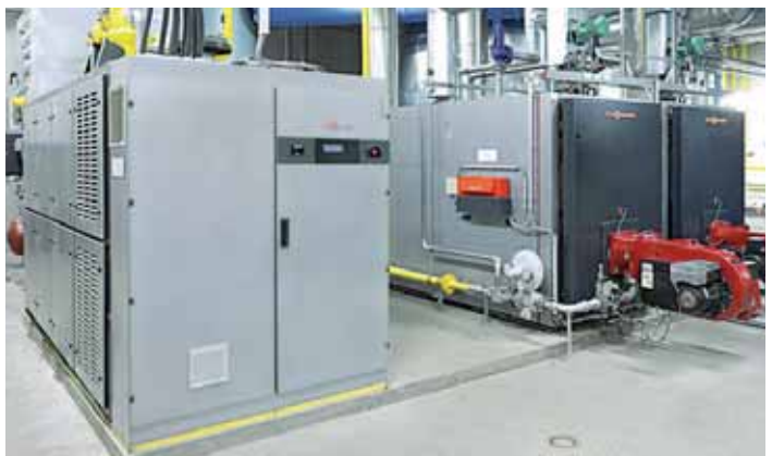
Blockheizkraftwerk (links) im Badeparadies Schwarzwald, zwei Vitoplex Kessel liefern bei Bedarf die Spitzenlast
